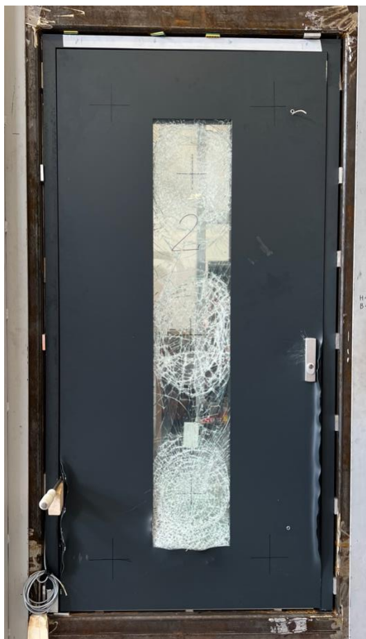
Widoczne uszkodzenia. Widok ogólny obiektu po badaniach.
