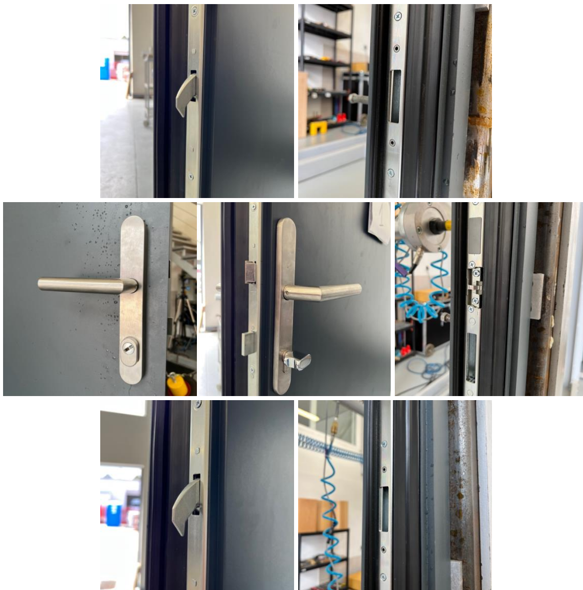
Fot. 8, 9, 10, 11, 12, 13, 14 Punkty ryglowania oraz blachy zaczepowe. Widok od góry skrzydła do dołu.
